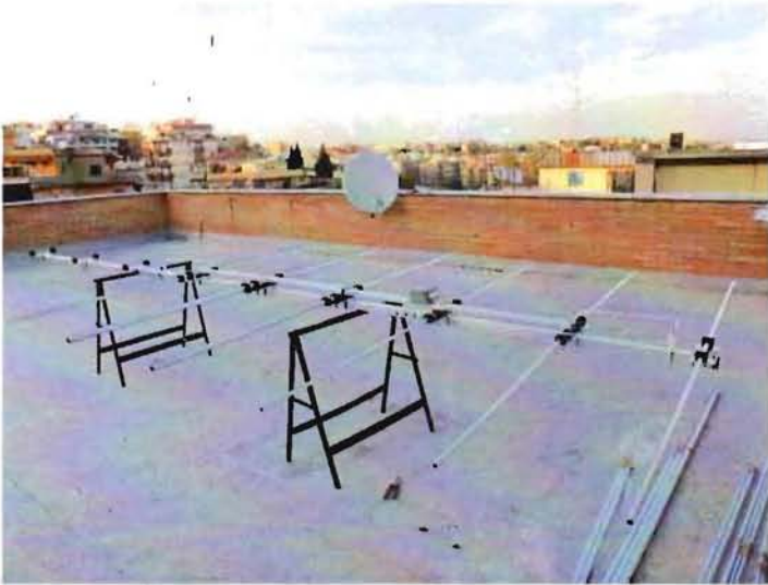
Gesamtansicht Strahlerzellenbereich Complete view of the driver cell area
